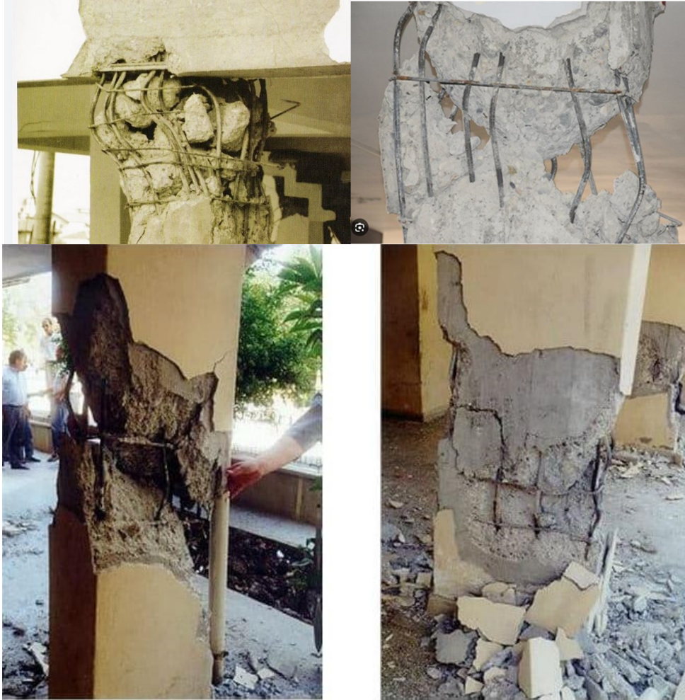
Şekil 4. Donatı burkulması meydana gelen yapı elemanı
